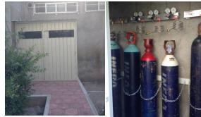
Caseta de gases
