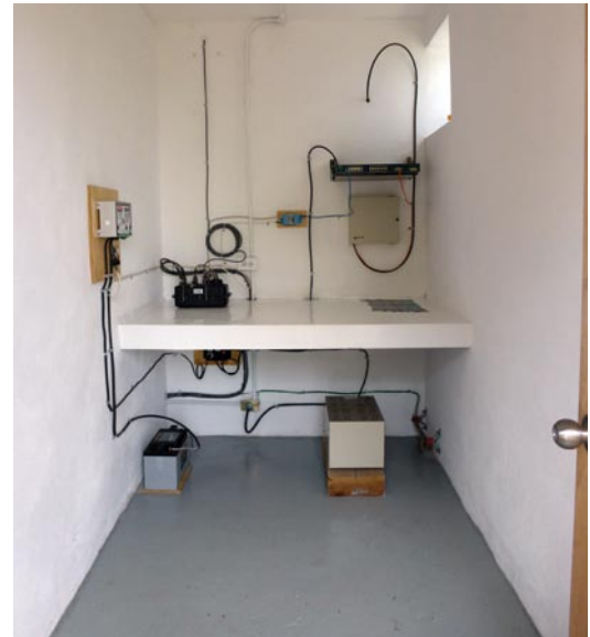
Equipamiento en el interior de la estación sísmológica de Monterrey
